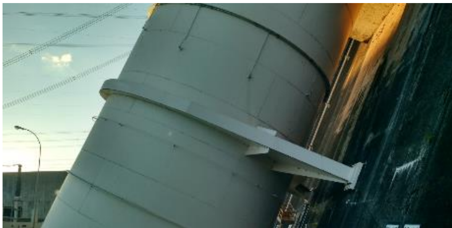
Figura 8 - Vista do conduto forçado com os transdutores acústicos
